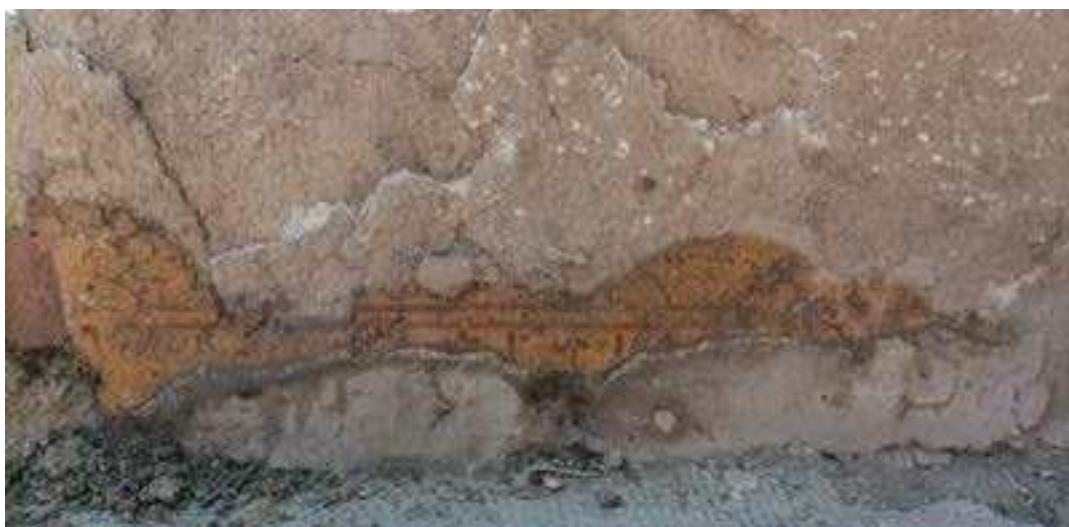
Fig. 178 Domus 4. Ambiente 38. Parete S, porzione inferiore della zoccolatura, secondo strato sovrapposto alla pellicola pittorica
