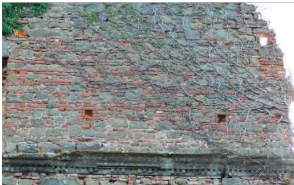
fig. 150 – Palazzaccio a Marcignano: particolare della muratura di XVI secolo (Tipo 7).
