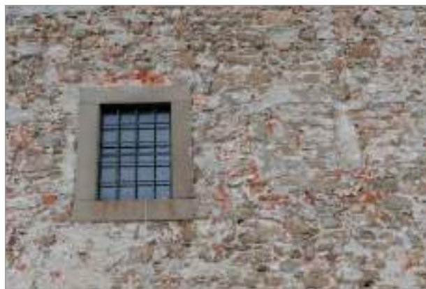
fig. 71 – Montisoni: finestra in pietra serena frutto dei restauri ottocenteschi con, a lato, l'apertura originaria tamponata.
