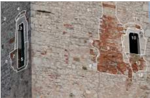
fig. 93 – Particolare del sistema di aperture ai piani superiori della casatorre Le Nutrici.
